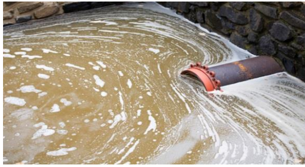
In figura: acque reflue
